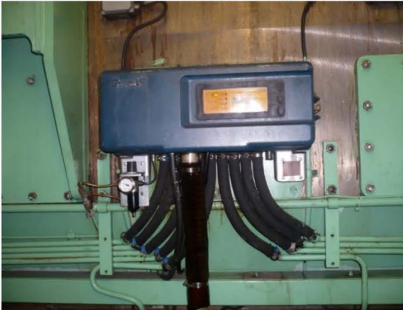
Existing OMD system.....
